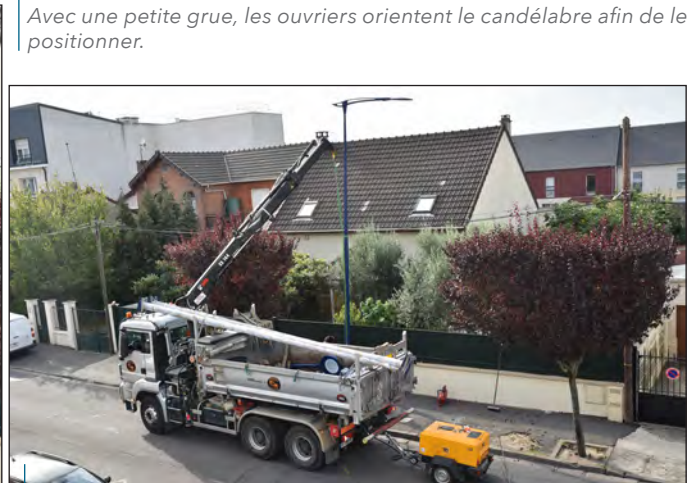
Une fois mis en place, le nouveau candélabre est raccordé à l'électricité. Une coulée de béton tout autour viendra finaliser la pose.
