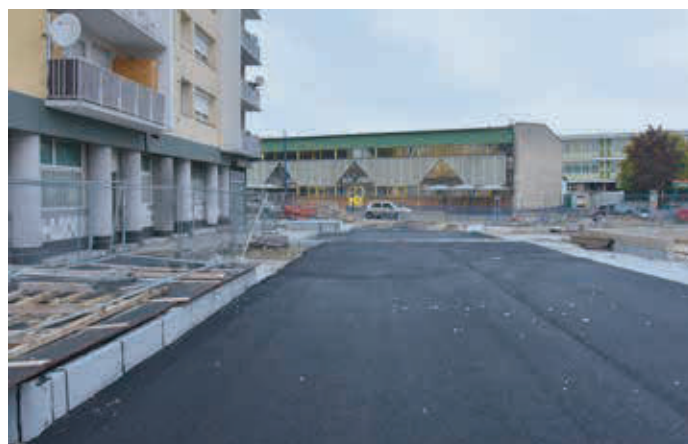
Les travaux de réaménagement du parking souterrain et de création de la rue Robert Manuel entre les tours 8 et 9, ont repris fin juillet. Ils avaient dû être interrompus plusieurs mois. La dalle sur laquelle reposait la future rue présentait des défauts non structurels qui ont retardé la réalisation de l'étanchéité du parking. Tout étant aujourd'hui rentré dans l'ordre, le réaménagement du parking devrait être terminé courant octobre et la création de la rue, d'ici fin novembre.
