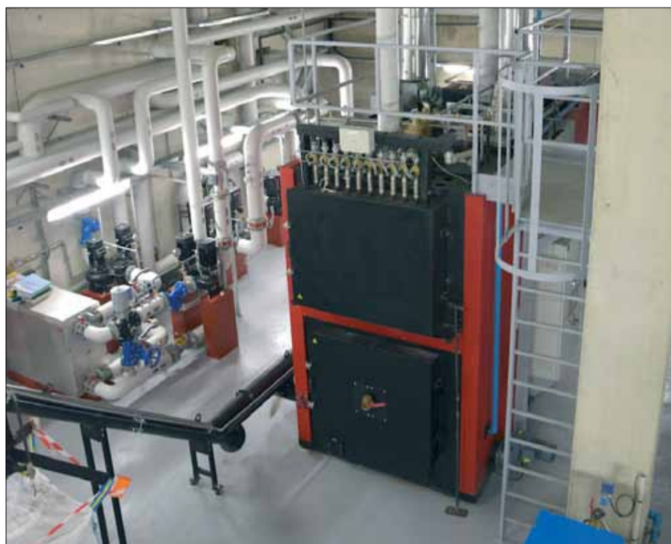
La chaufferie biomasse.
