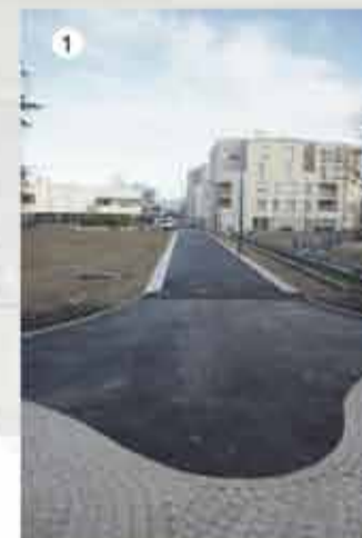
Rénovation urbaine Pierre Sénard Création des voies Loucheur, Leblanc, République, Martin Luther King et de la placette du collège. Elles ont été réalisées afin de finir l'aménagement de l'espace public du quartier. Coût des travaux : 850 000 €.
